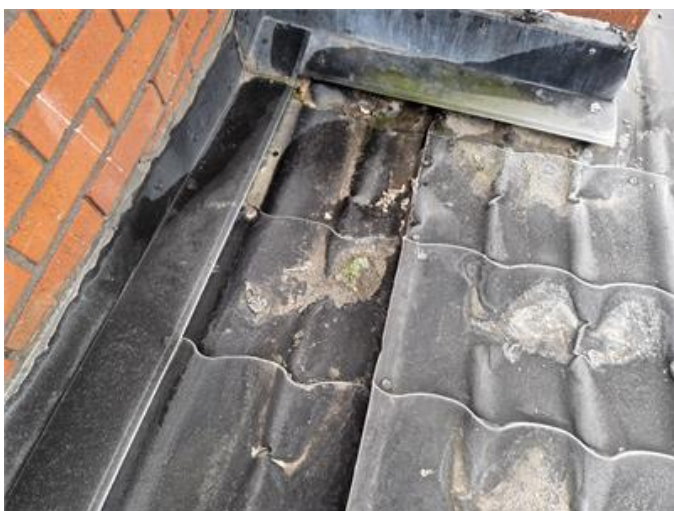
Tak: Takplåt delvis knölig och skruvar saknas. Se även bild sid 5.
