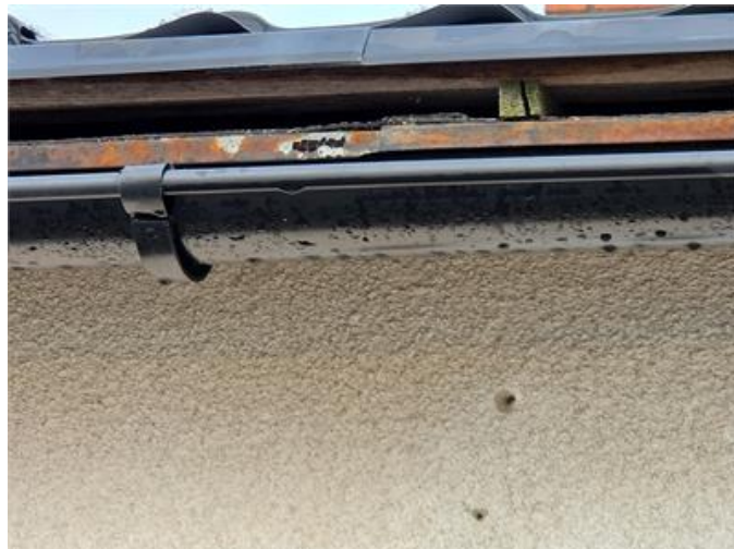
Tak: Fotplåt har rostangrepp/rosthål. Se även bild sid 5.
