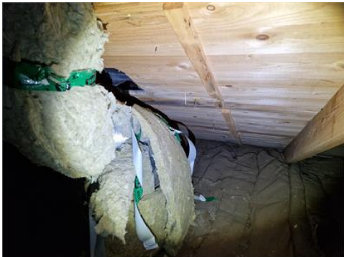
Vind: Fuktfleck förekommer lokalt vid rörgenomföring.
