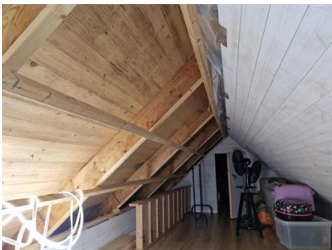
Nockvind, har varit inrett, mikrobiell påväxt på underlagstaket.
