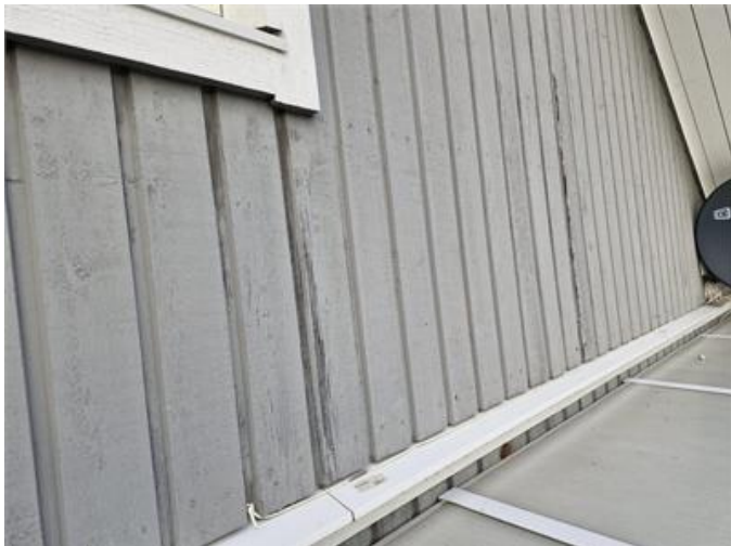
Fasad, behov av tvättning/målning.
