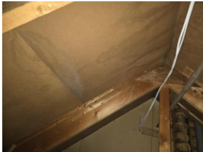
Exempel på fuktfläckar på vinden. Om fuktfläckarna ökar/växer bör kontakt tas med fackman för vidare kontroll/åtgärd.
