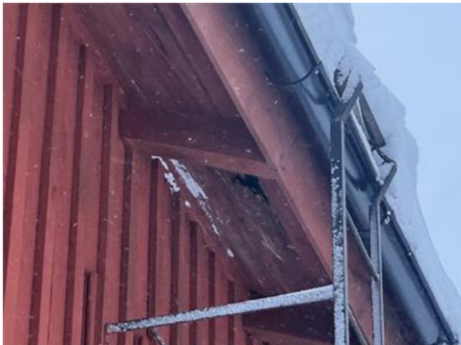
Bilden visar rötskador i takfot på baksidan.
