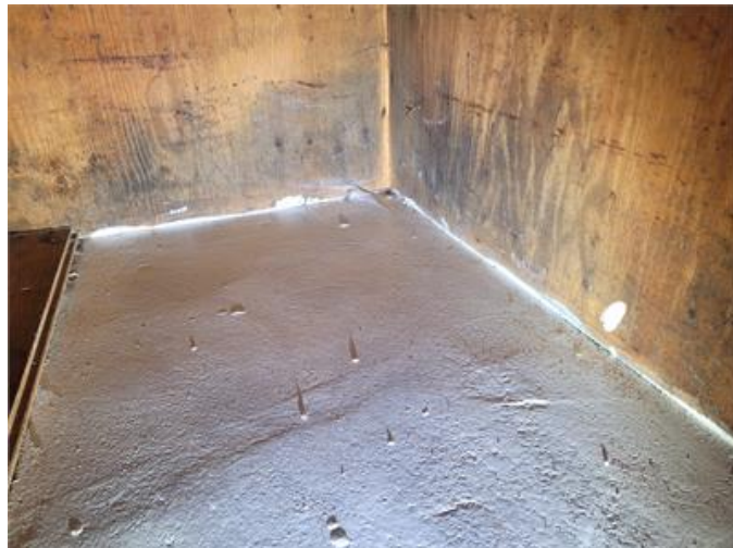
Missfärgning samt hög fuktkvot i vägg.
