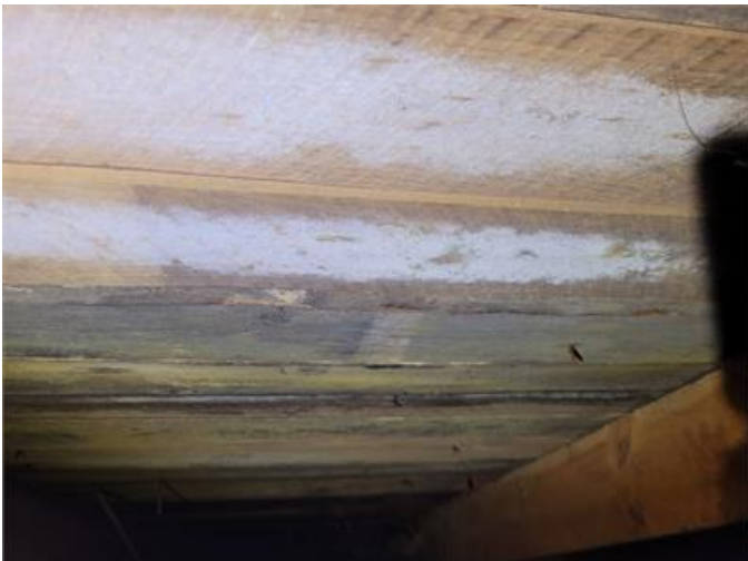
Mikrobiell påväxt på vind.
