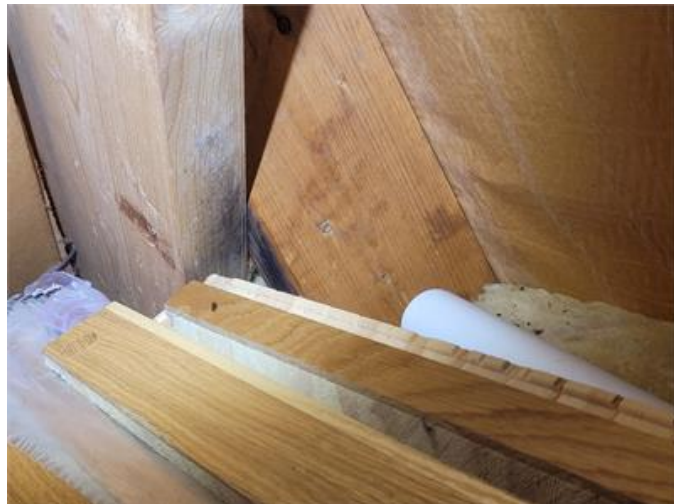
Mikrobiell påväxt på vind
