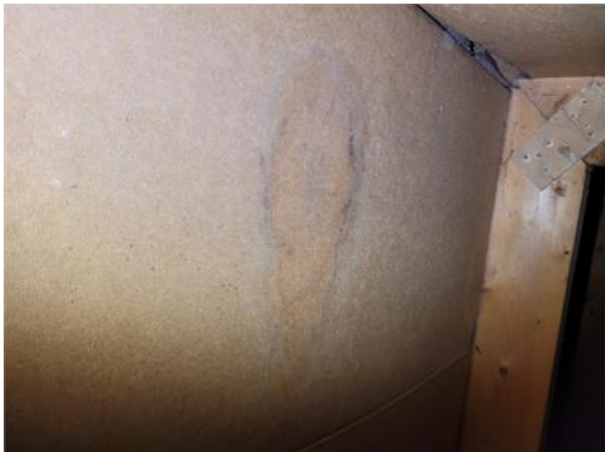
fuktfläck på underlagstak
