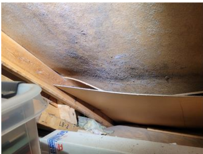
Mikrobiell påväxt på vind
