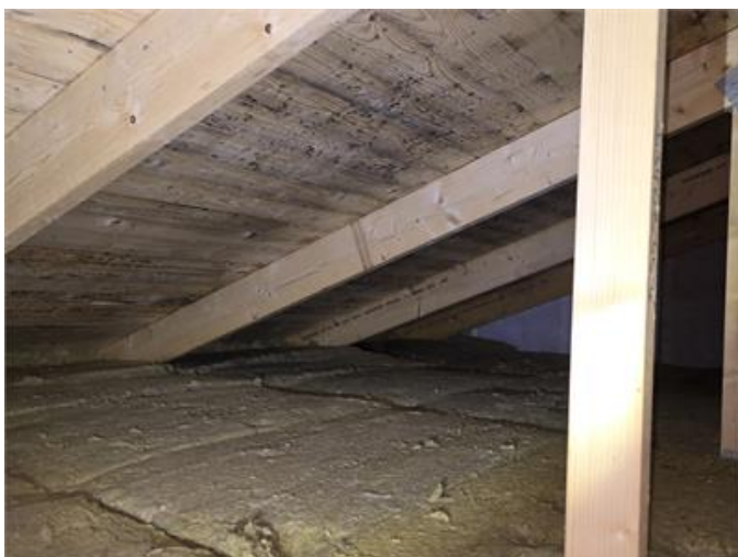
Nockvind ny del: Mikrobiell påväxt i underlagtak.
