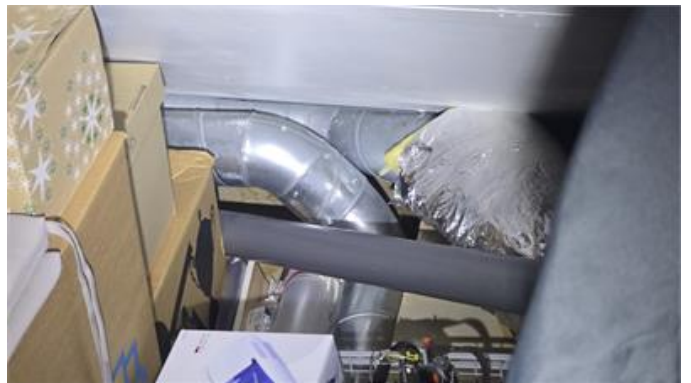
Oisolerade ventilationsrör, förråd , inredd vindsdel.
