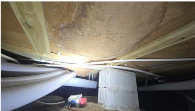
Exempelbild, fuktfläck/missfärgning blindbotten, krypgrund.
