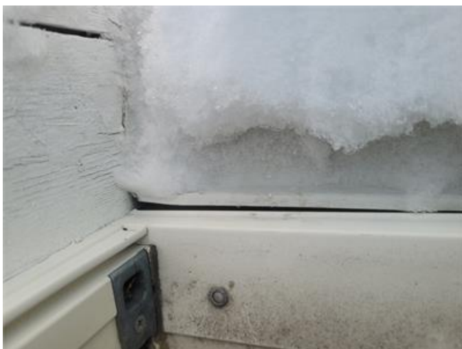
Fönsterbleck med justeringsbehov
