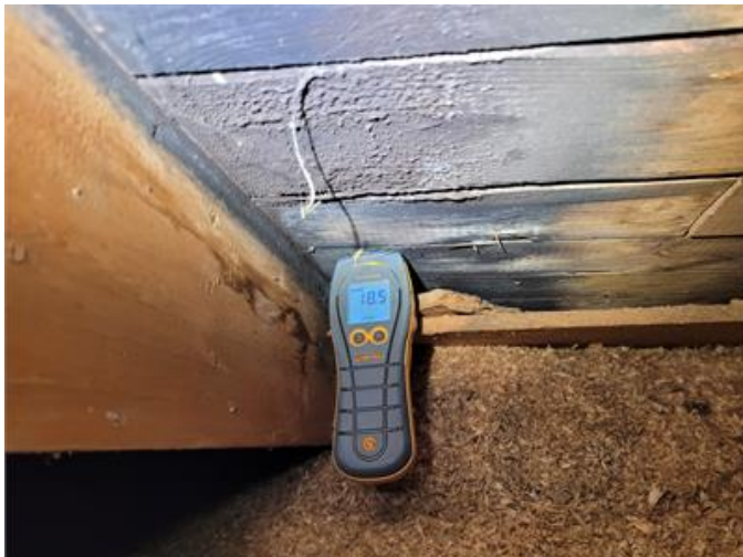
Mikrobiell påväxt på underlagstak.
