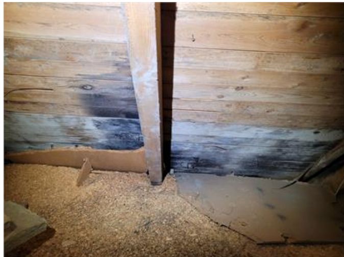
Mikrobiell påväxt på underlagstak.
