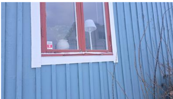
Exempelbild, målning/underhållsbehov fönster.
