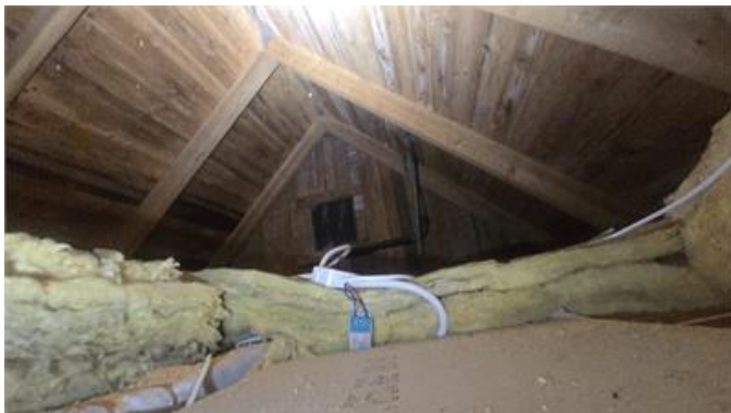
Översiktsbild, vindsutrymme. Mikrobiell påväxt och fläckar på underlagstak, bristfällig elinstallation.
