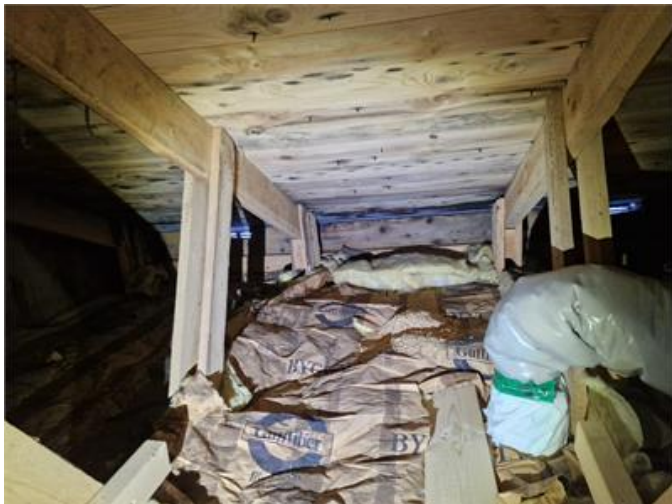
Underlagstak med fukt/mikrobiell påväxt samt frost
