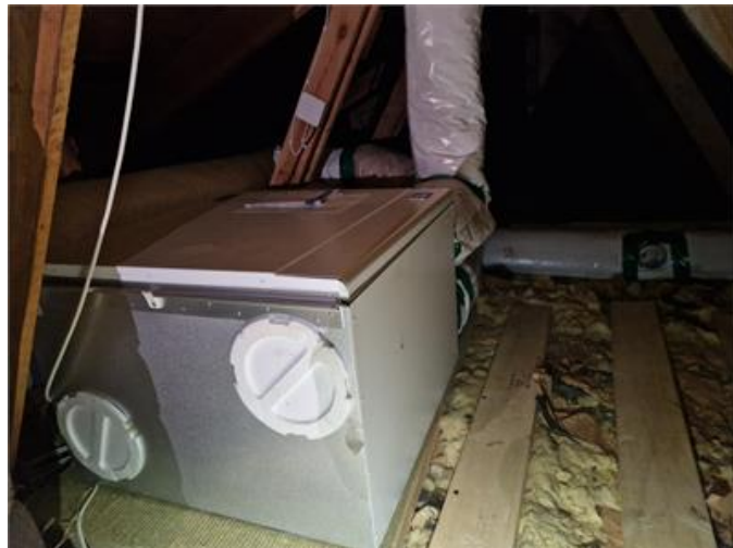
FTX aggregat installerat på vinden
