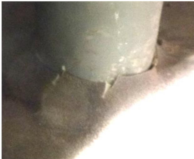
Otät matta i duschrum under varmvattenberedare
