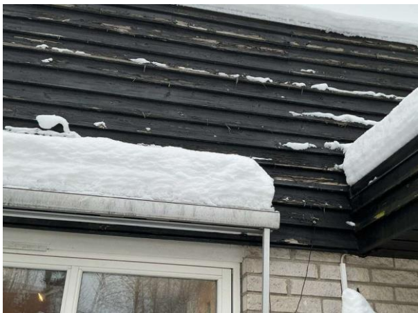
Bild 1: - Utvändigt, Fasad, Fasadpanel på framsidan är i behov av byte Del av fasadpanelen är nära altanen vilket medför...
