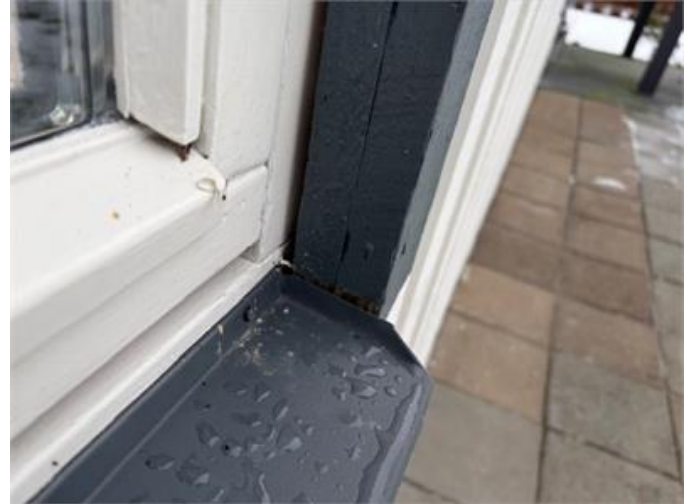
Otättheter mellan några fönsterpatier och foder/smyg samt bleck och smyg vilket rekommenderas att tätas.
