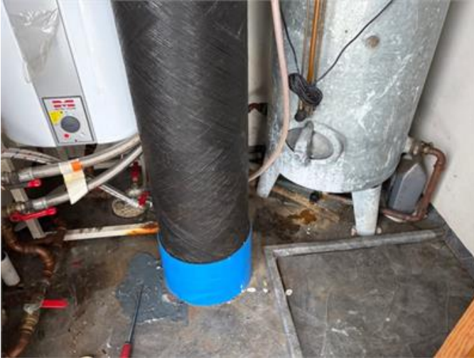
Droppläckage noterades från ventil under hydrofor.
