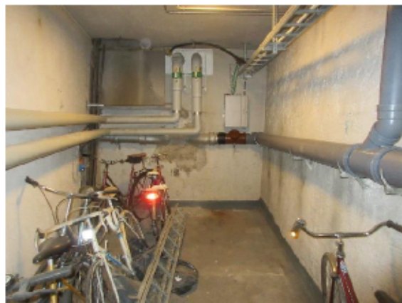
Avloppet ut över källargolvets nivå
