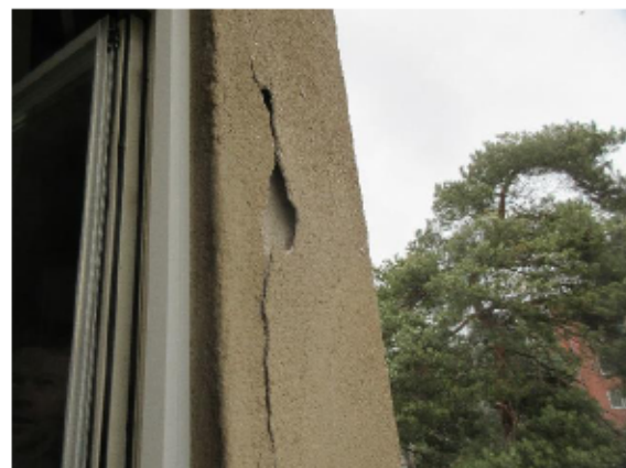
Skadad puts vid en balkong
