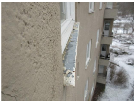
Färgen flagar på fönsterbleck
