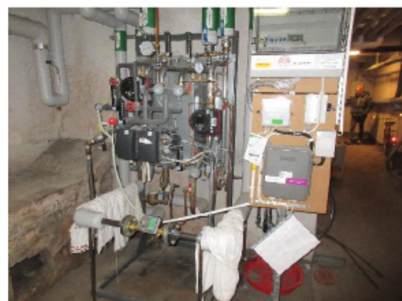
Undercentral för värme och tappvarmvatten
