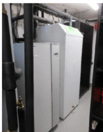
Bergvärmepump med kringutrustning
