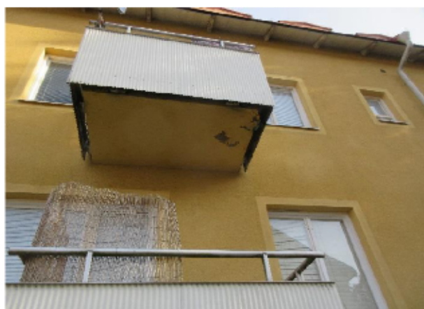
Skadad balkongplatta i betong
