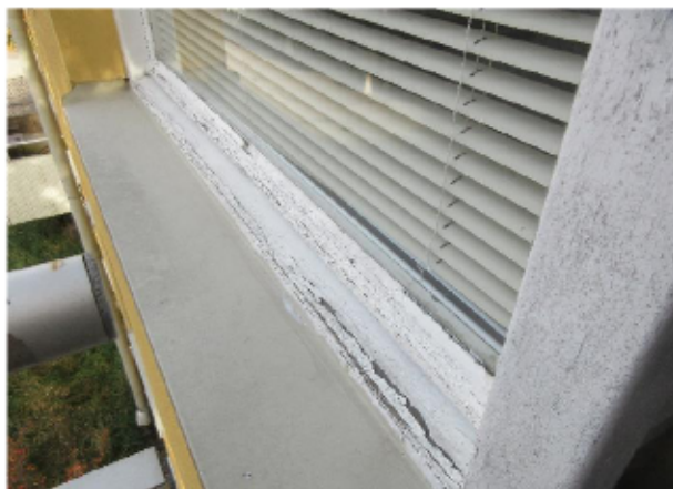
Fönster i behov av underhåll
