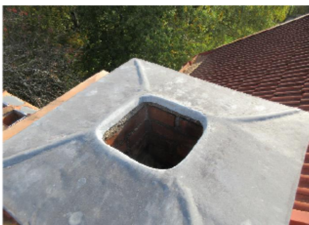
Pannskorstenen som inte är väderskyddad
