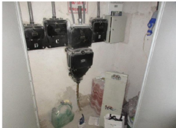
Inkommande el är från byggnadsåret
