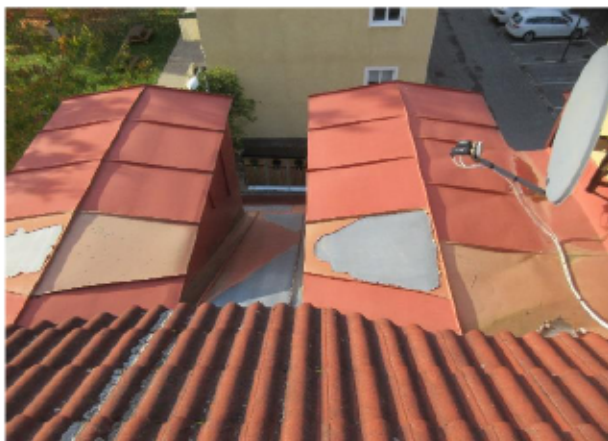
Yttertak där färgen flagar på plåtdetaljer
