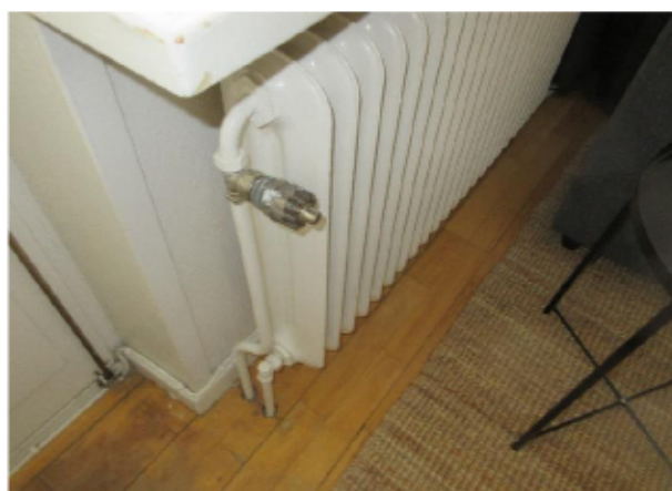
Gamla termostatventiler på radiatorerna.
