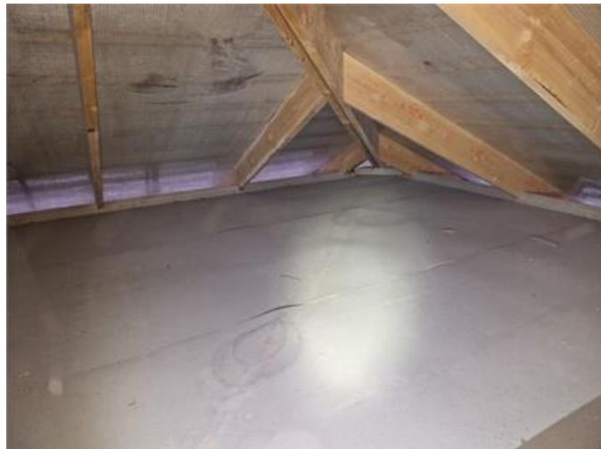
Nockvind, torra fuktanvisningar på golvytan nedan vinkelnockar.
