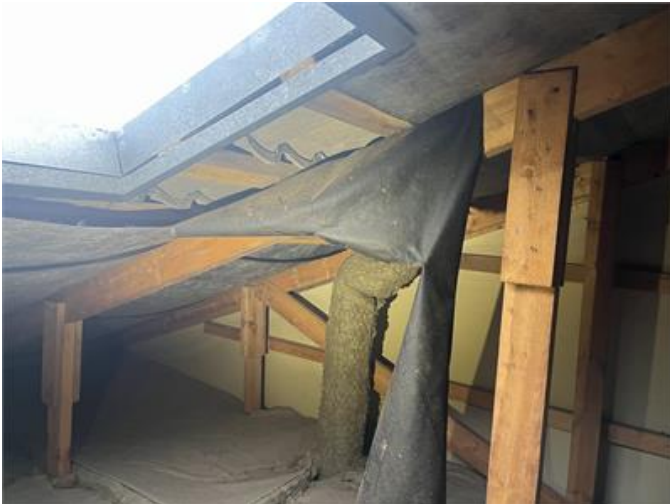
Underlagsduk på vinden vid vindsluckan som släppt vid infästning.
