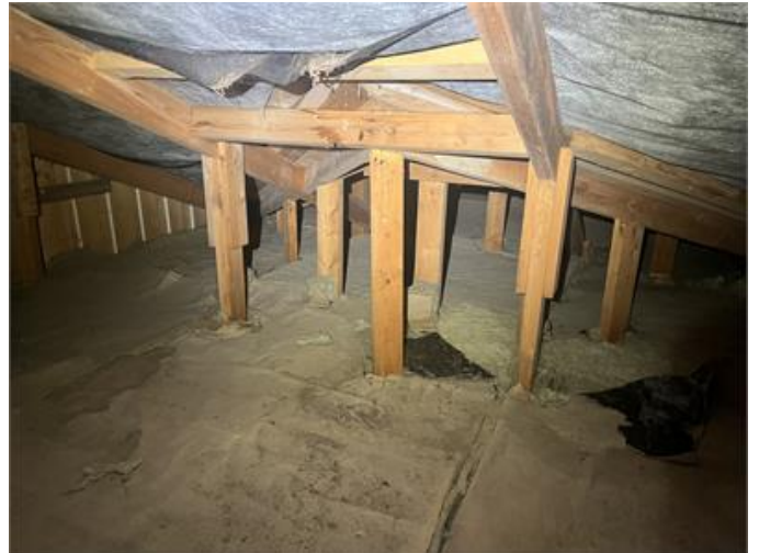
Bilden visar del av vinden, mindre fuktfläck på del av takstol samt någon fuktros på ovasida isolering. Vinden bör regelbundet kontrolleras.
