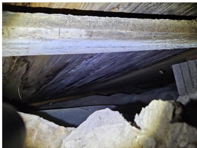
Äldre fuktskada på blindbotten
