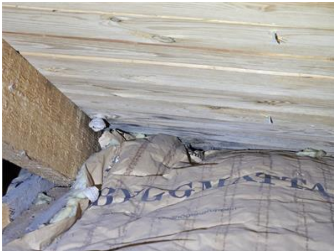
Läckage i yttertak.
