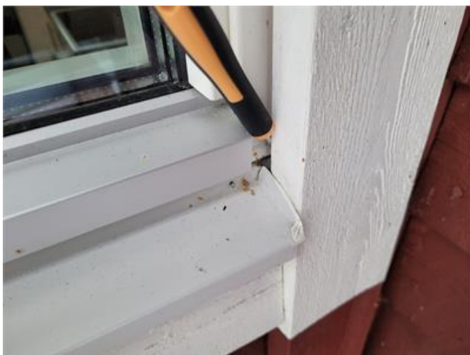
Otättheter förekommer mellan fönsterbleck och karm.
