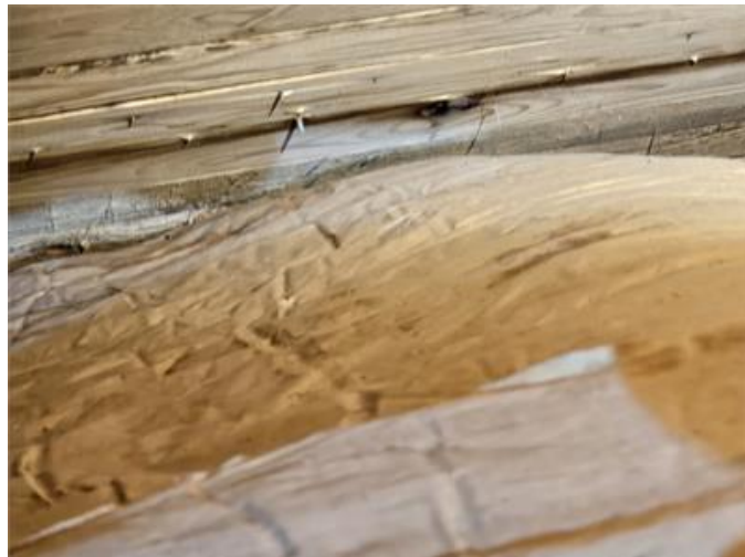
Läckage i yttertak.
