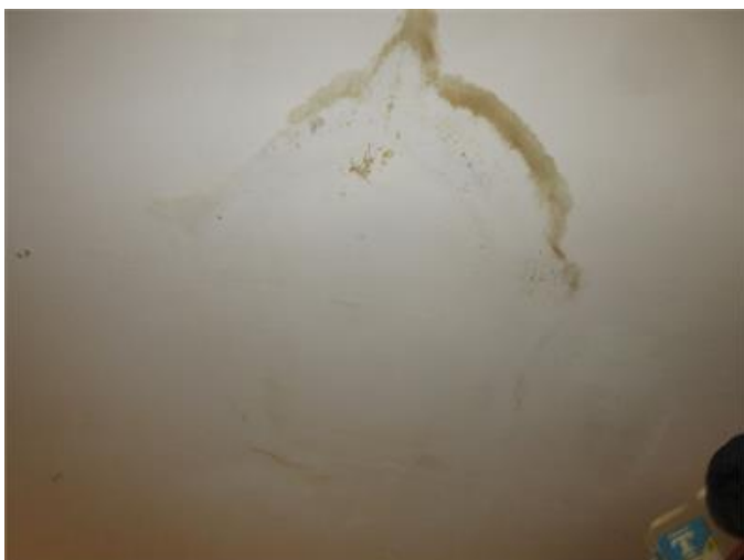
Missfärgningar/fuktfläckar i förrådstak i källare.
