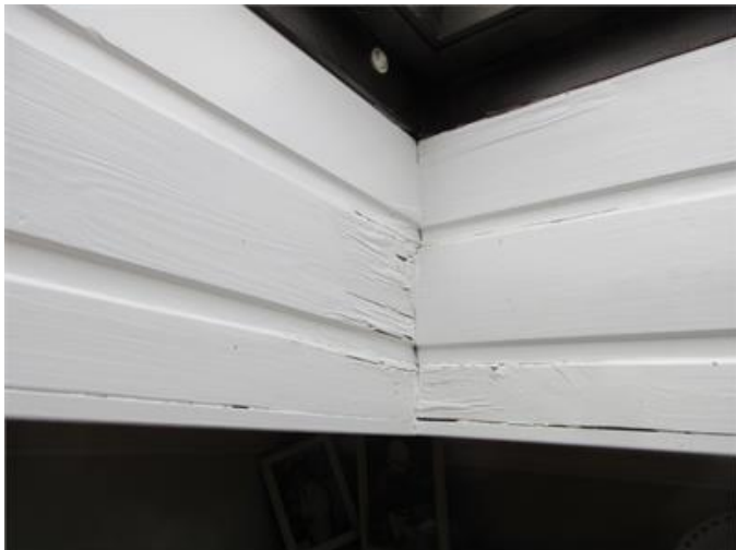
Färgsläpp/torrspäckor i smyg takfönster
