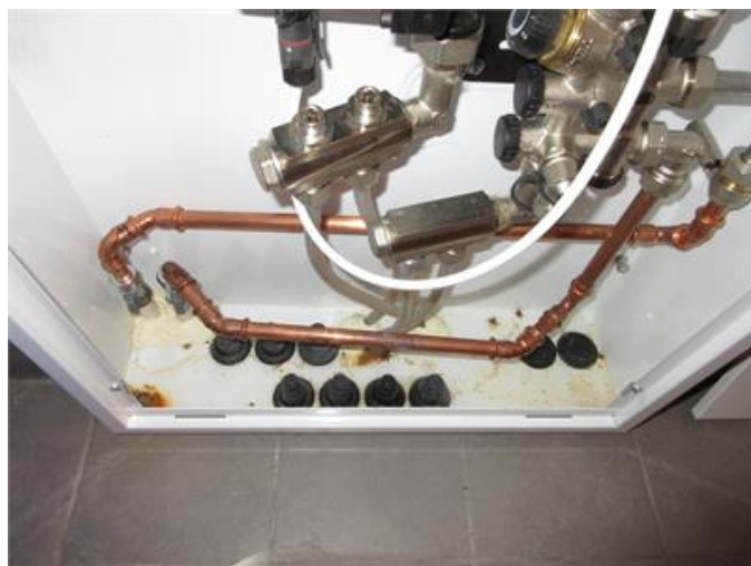
Läckage i skåp till golvvärmecentral i gästrum.
