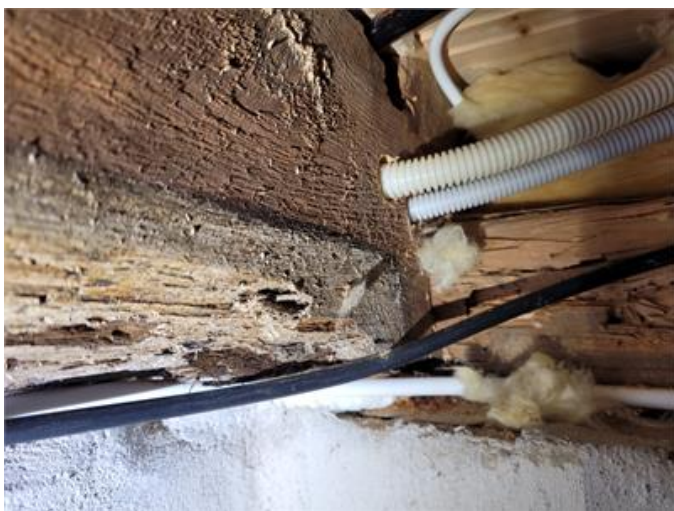
Äldre rötskador i bjälklag.
