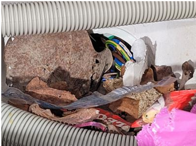
Möss har gnagt på elinstallationer.
