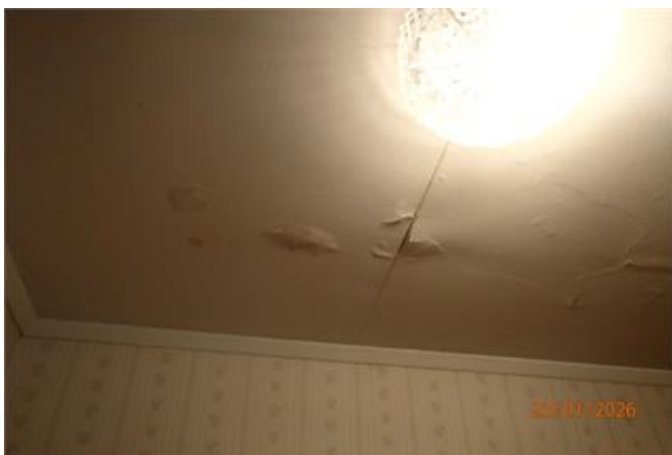
Skada noterades på innertaket i hallen.
