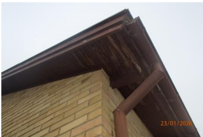
Rötskada i takfot.
