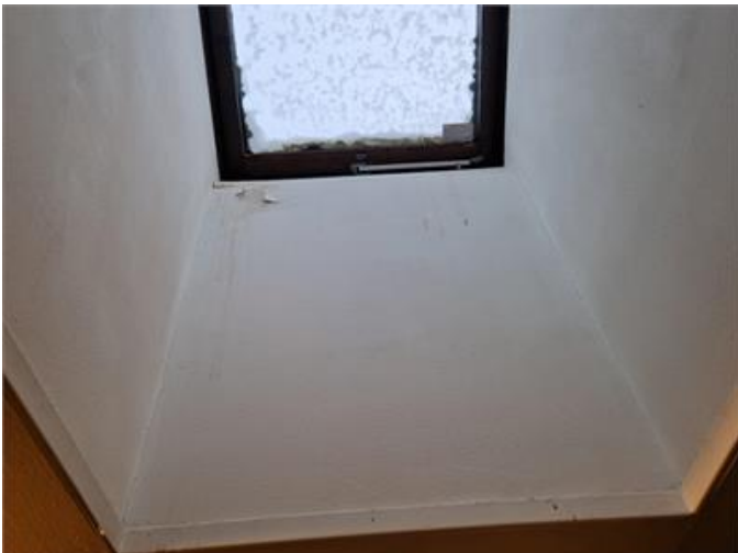
Trappa/Hall: Fuktfläckar förekommer under takfönster.
