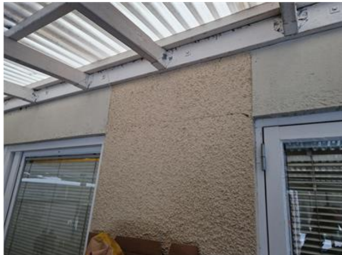
Fasad: Spricka noterades i fasad.
