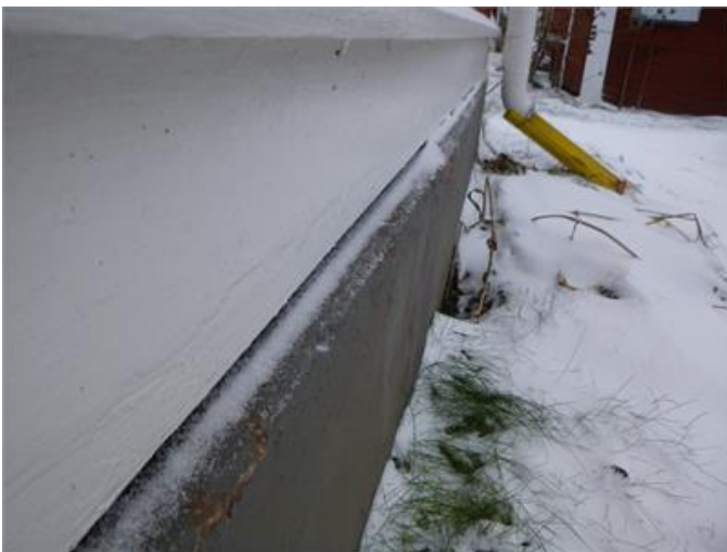
Avrinningsplåt/offerbräda saknas mellan fasad och sockel
