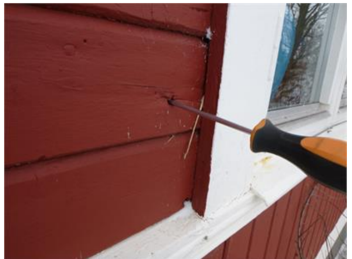
Rötskador i fasad
