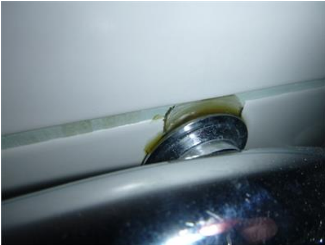
Silikontätning kring duschens blandare
