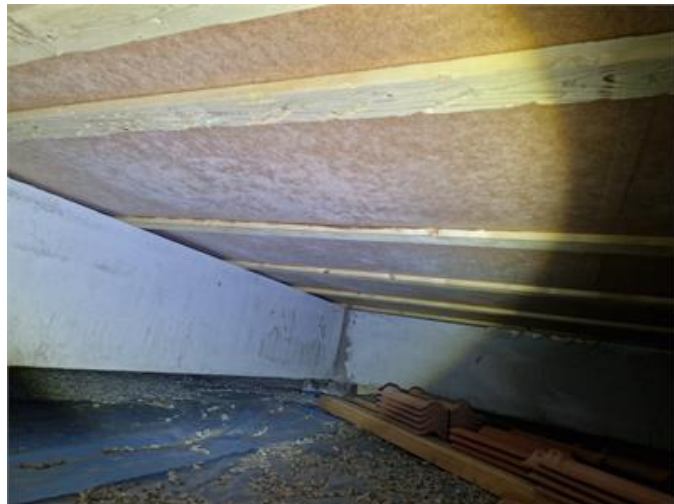
Krypgrund: Mikrobiell påväxt förekommer på blindbottenskivor.
