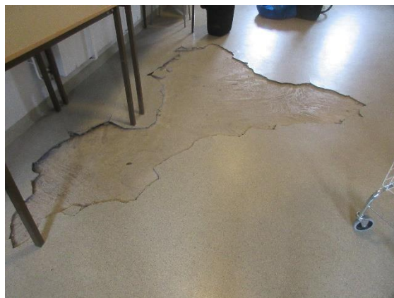
Skadat golv i tvättstugan
