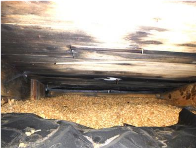
Förhöjda fuktvärden på insida yttertak med mikrobiella missfärgningar
