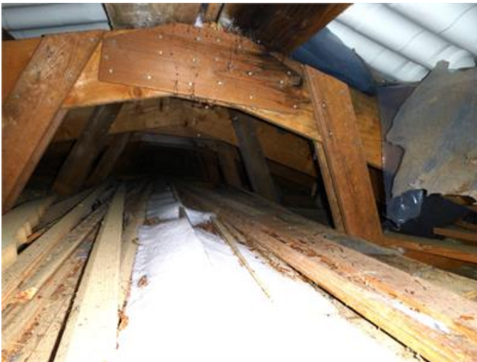
Yrsnö har trängt in på vinden i garaget
