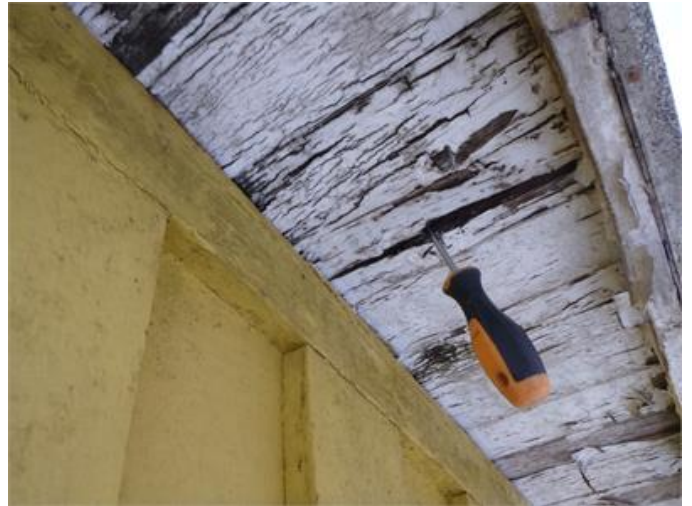
Rötskador efter takläckage i takfoten
