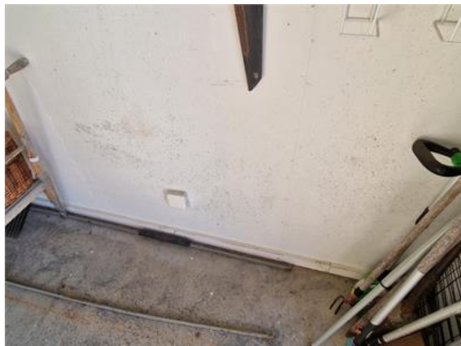
Garage: Mikrobiell påväxt noterades ytligt på garagevägg.
