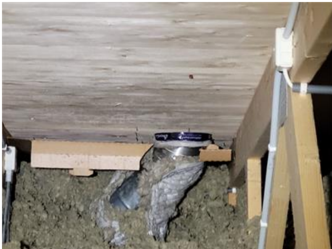
Ventilationskanal bör isoleras.
