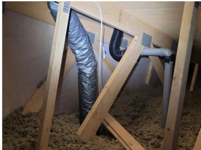
bakfall på avloppsavluftningen
