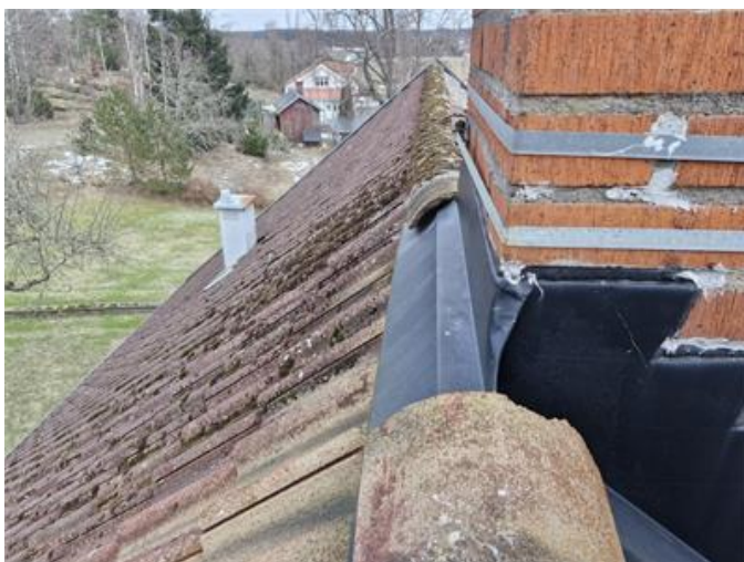
Taket original med mosspåväxt på pannorna och tätning utförd vid skorsten.
