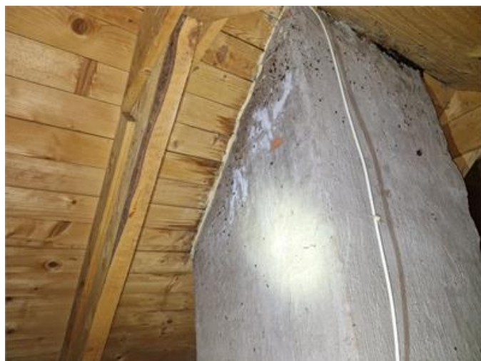
Nockvind, torra fuktanvisningar runt skorsten.
