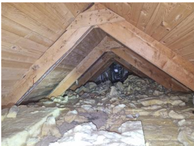
Nockvind översiktsbild, mikrobiell påväxt i underlagstaket ovan våtrum.
