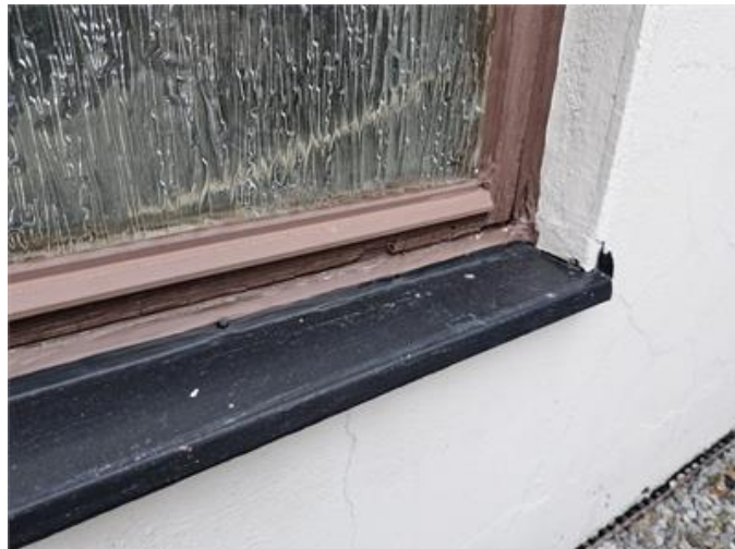
Flera äldre fönster, enstaka med rötskada.
