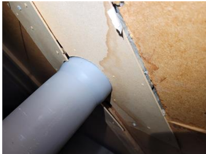
Äldre fuktfläckar på blindbotten
