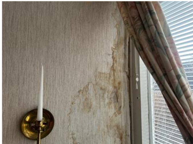
Fuktfläck i vardagsrum.
