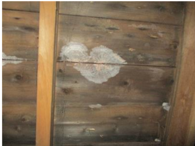
Svamppåväxt insida yttertak i vind
