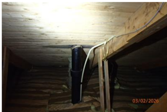
Missfärgning av råsponten runt luftar röret på vinden.
