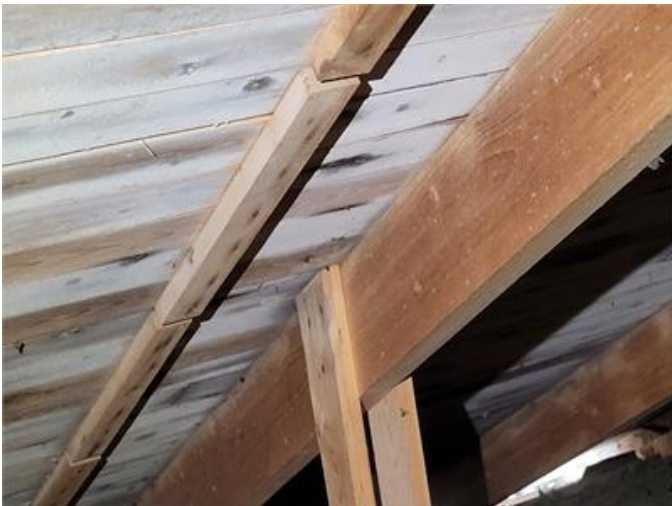
Mikrobiell påväxt på underlagstak.
