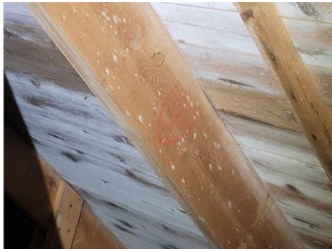
Mikrobiell påväxt på underlagstak.
