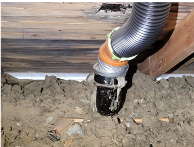
Avloppsavluftningen är ej fackmässigt monterad.
