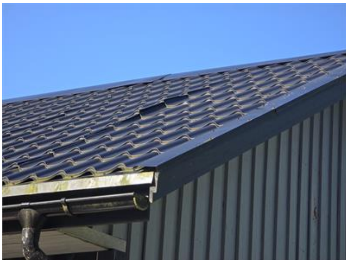
Skarv på plåttak som rest sig.
