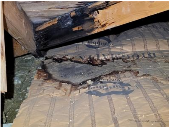
Läckage i yttertak
