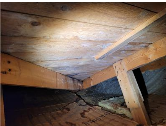
Mikrobell påväxt samt läckage i underlagstak
