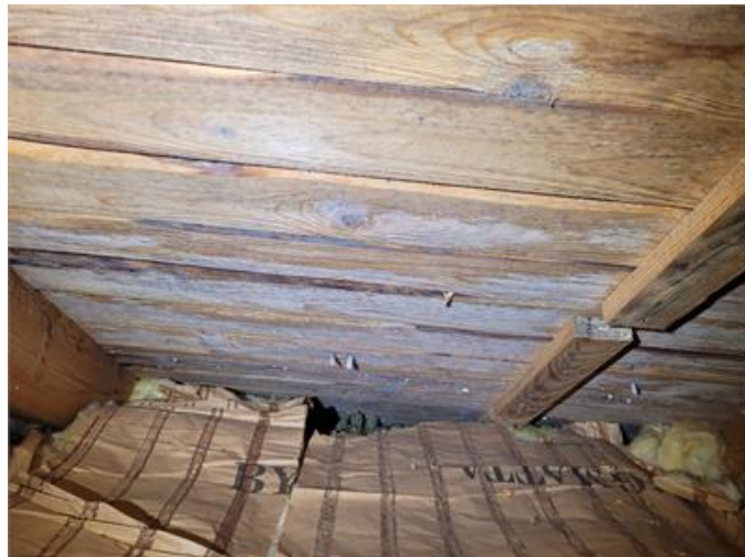
Mikrobell påväxt samt rimfrost på underlagstak
