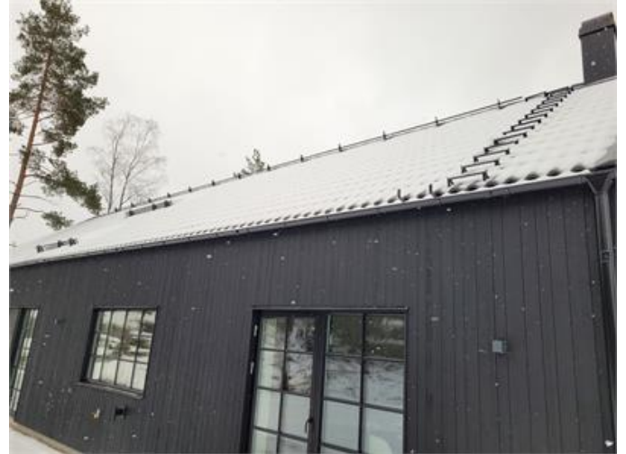
- Snörasskydd saknas på väg till entrédörren.
