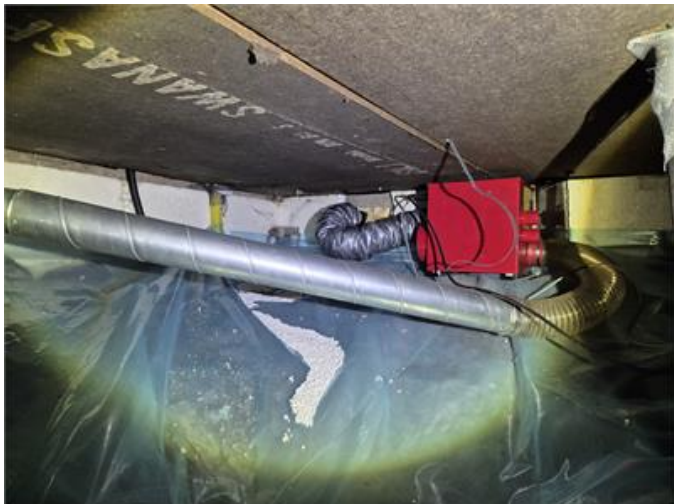
Bild av krypgrundens avfuktarinstallation.
