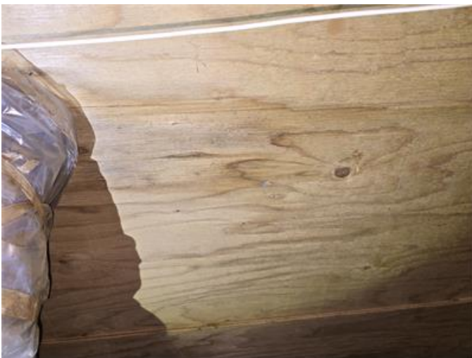
Nockvind: Fuktigt runt genomföring till avloppsavluftare.
