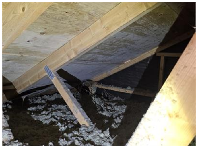
Nockvind: Ytlig vitaktig mikrobiell påväxt på underlagstak. Grenar noteras vid takfot mot söder.
