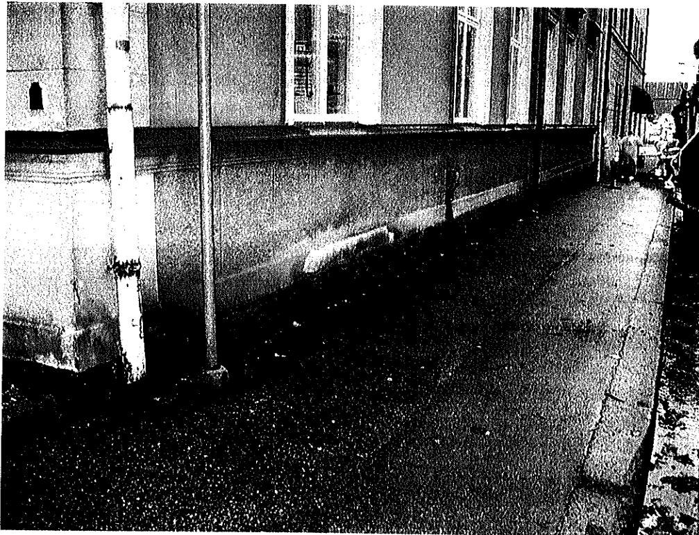
Gatufasaden med begynnande renoveringsbehov
