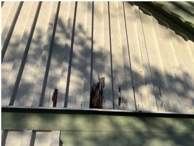
Rötskador i träfasaden.
