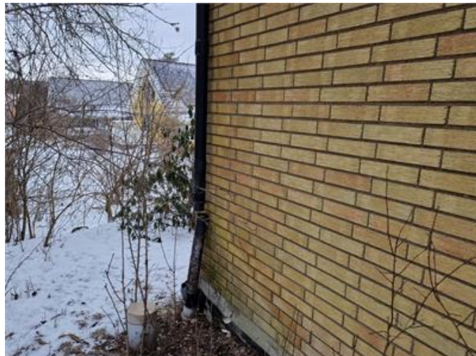
Fasad: Fuktuppsug/missfärgning förekommer i tegelfasad
