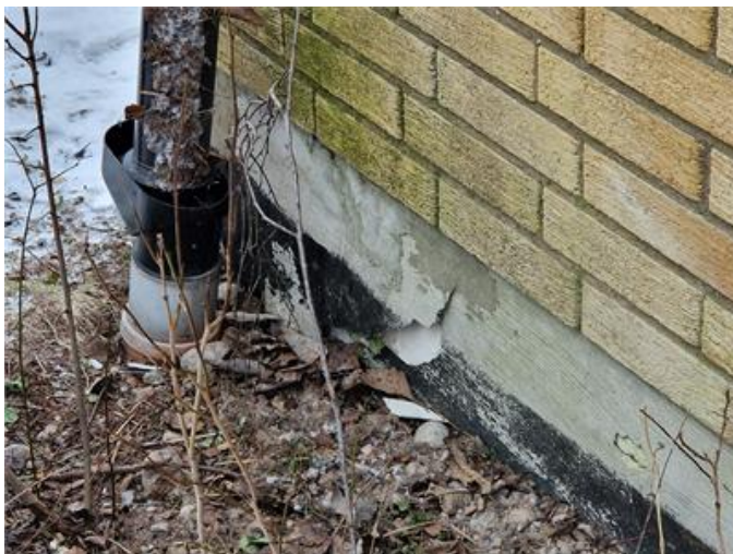
Sockel: Skador/Frostsprängningar förekommer.
