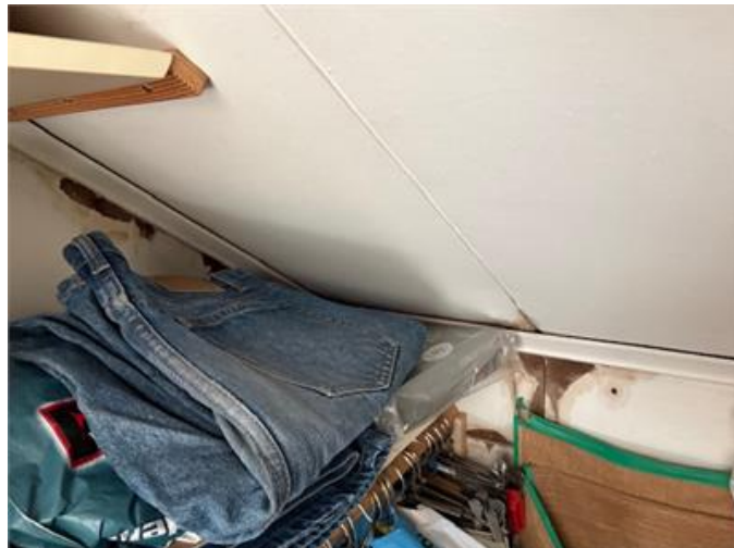
Bilden visar exempel på missfärgningar i tak/vägg.
