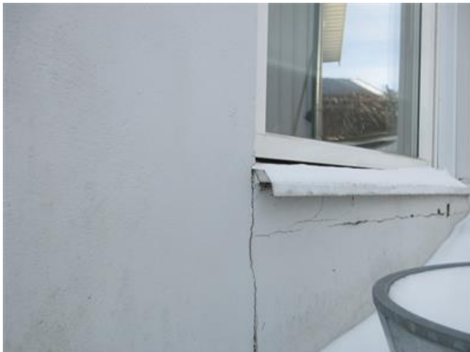
Exempel på sprickor i sockel
