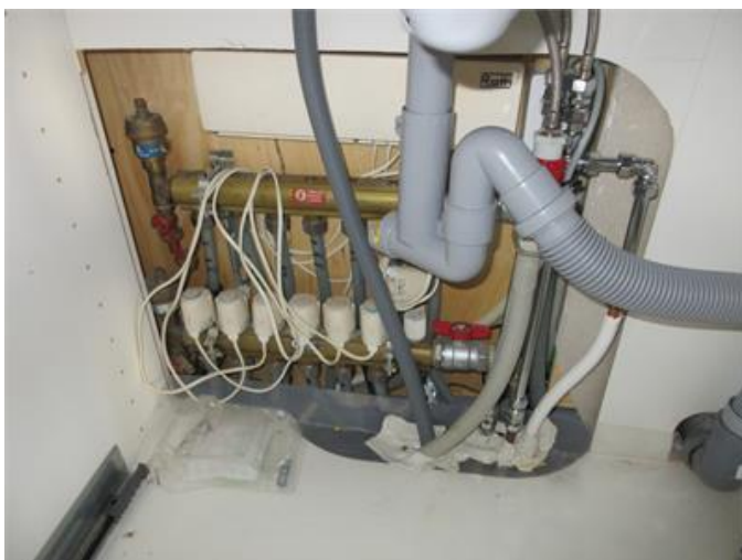
Golvvärmecentral i diskbänkskåp
