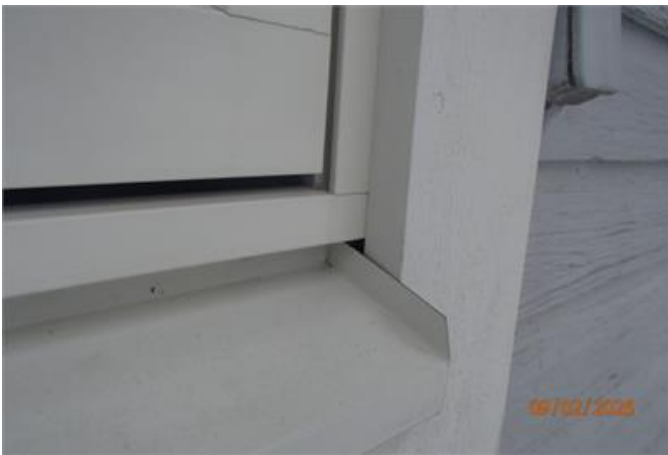
Otät vid fönsterbleck
