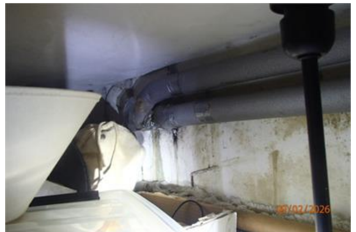
Kondens från rör till bergvärmens syns på källarvägg.
