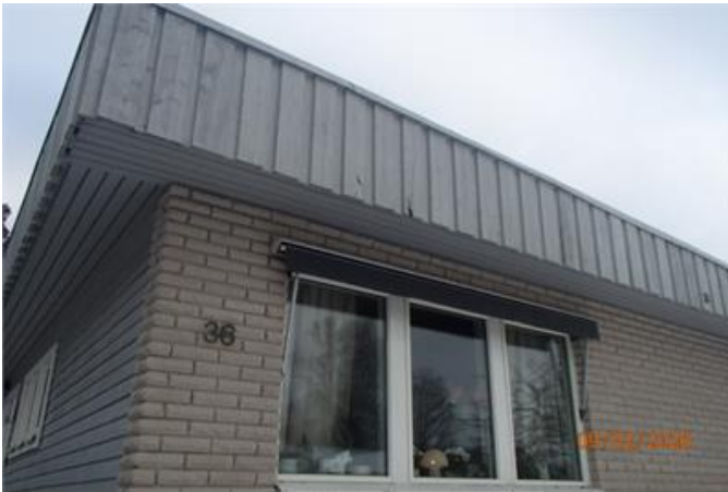
Rötskador noterades på panelen i takfärg.
