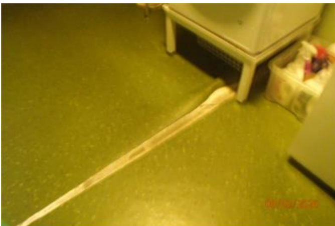
Mattan har släppt från underlaget. Tvättstuga i källare
