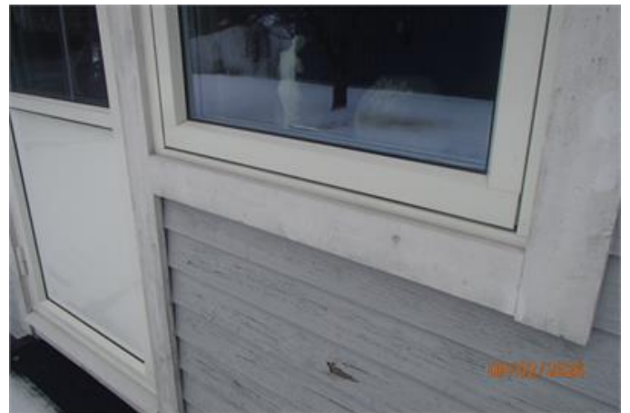
Fönsterbleck saknas vid sovrumsfönster.
