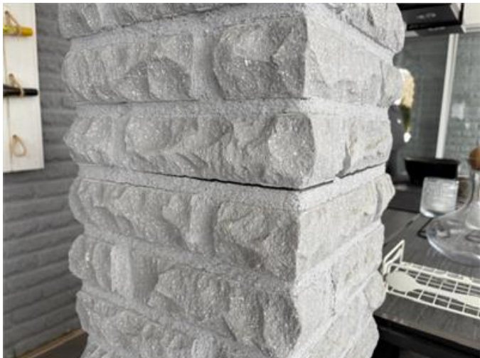
Bilden visar spricka i balkongens pelare.
