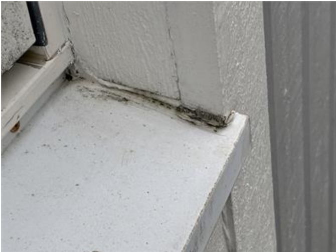
Fasad: Underbleck till flertalet fönster har ej uppvik, otätheter finns på några ställen.
