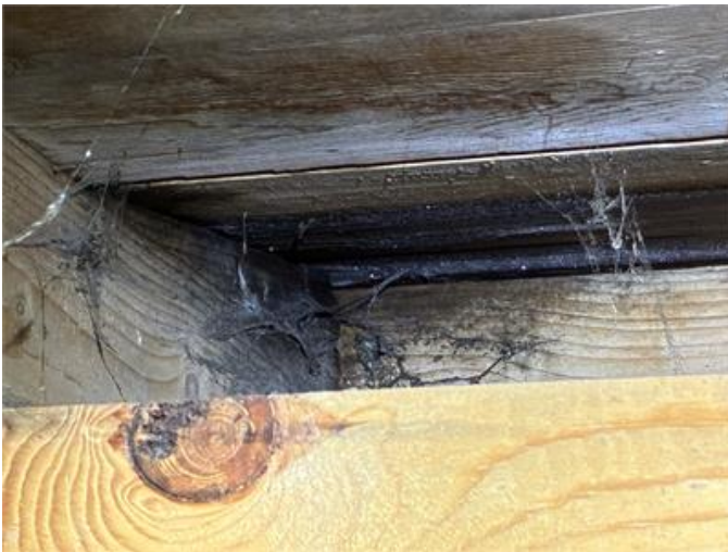
Nockvind: Fuktgenomslag finns på underlagstakets brädor längst ner vid takfot.
