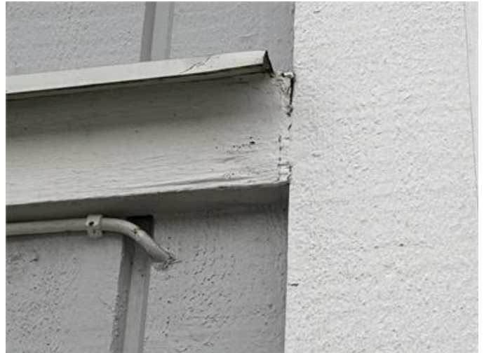
Fasad: Midjebräda har lokalt begynnande rötskada där ovanliggande midjeplåt ej har uppvik.
