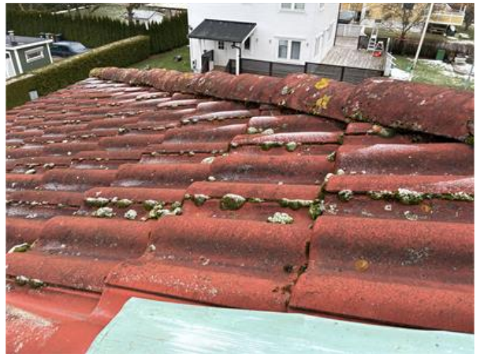
Tak: Översiktsbild, mosspåväxt finns på takpannor.
