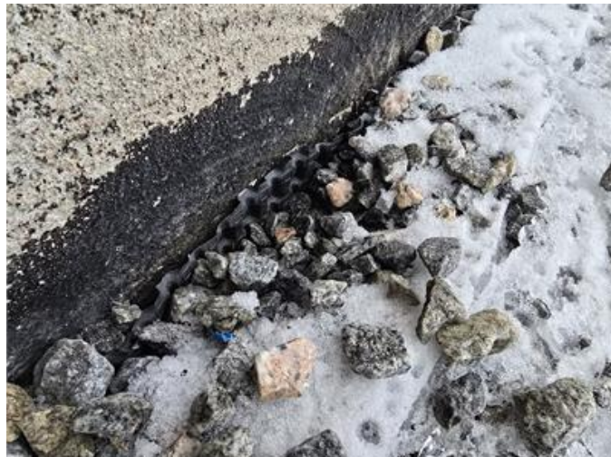
Sockel: Fuktskydd utan kantlist.
