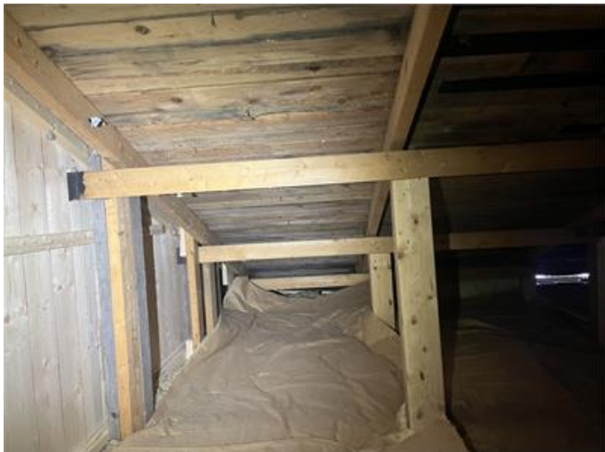
Bilden visar del av äldre vind där mikrobiell påväxt förekommer.
